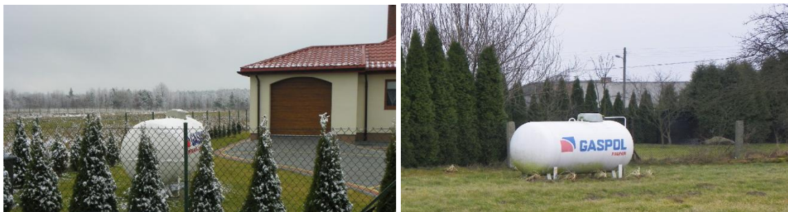
Fig. 2.6. Zbiornik z gazem ciekłym w Wąwale i Godaszewicach
